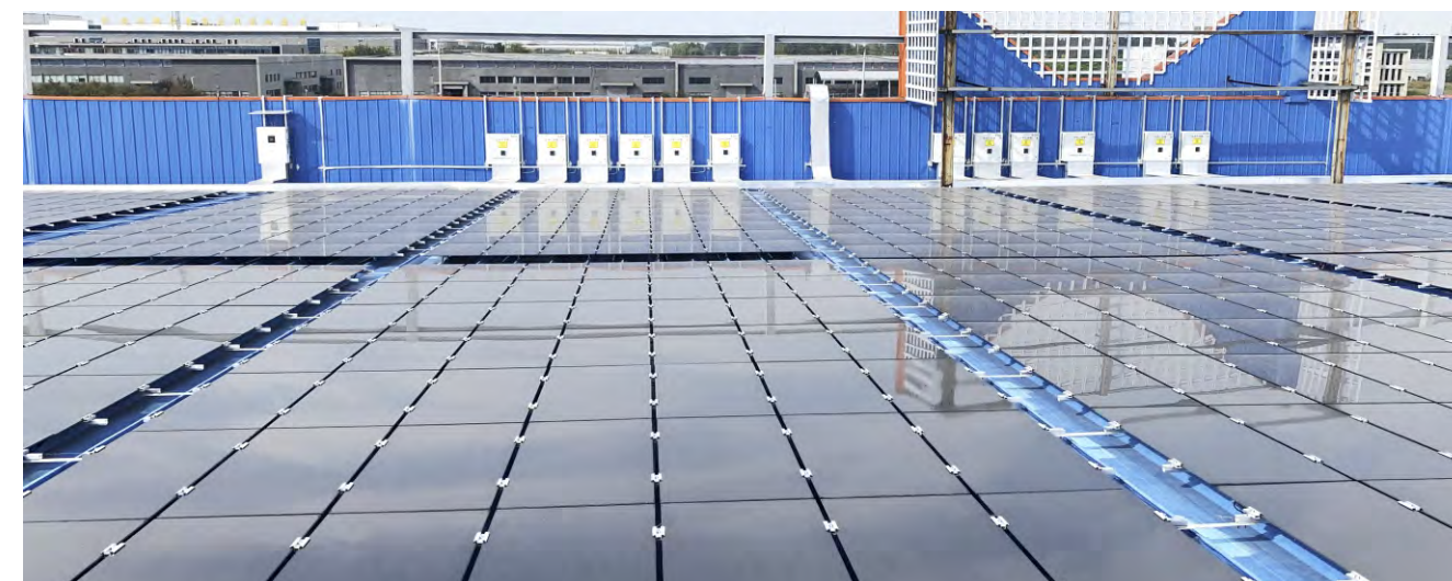
■ 润昌2.3MW屋顶光伏电站
