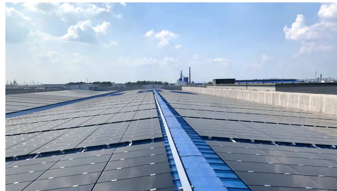
■ 鼎尔屋顶光伏电站
