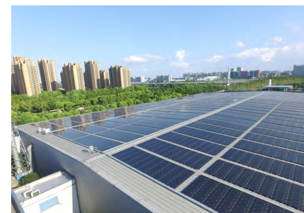
龙焱屋顶光伏电站
