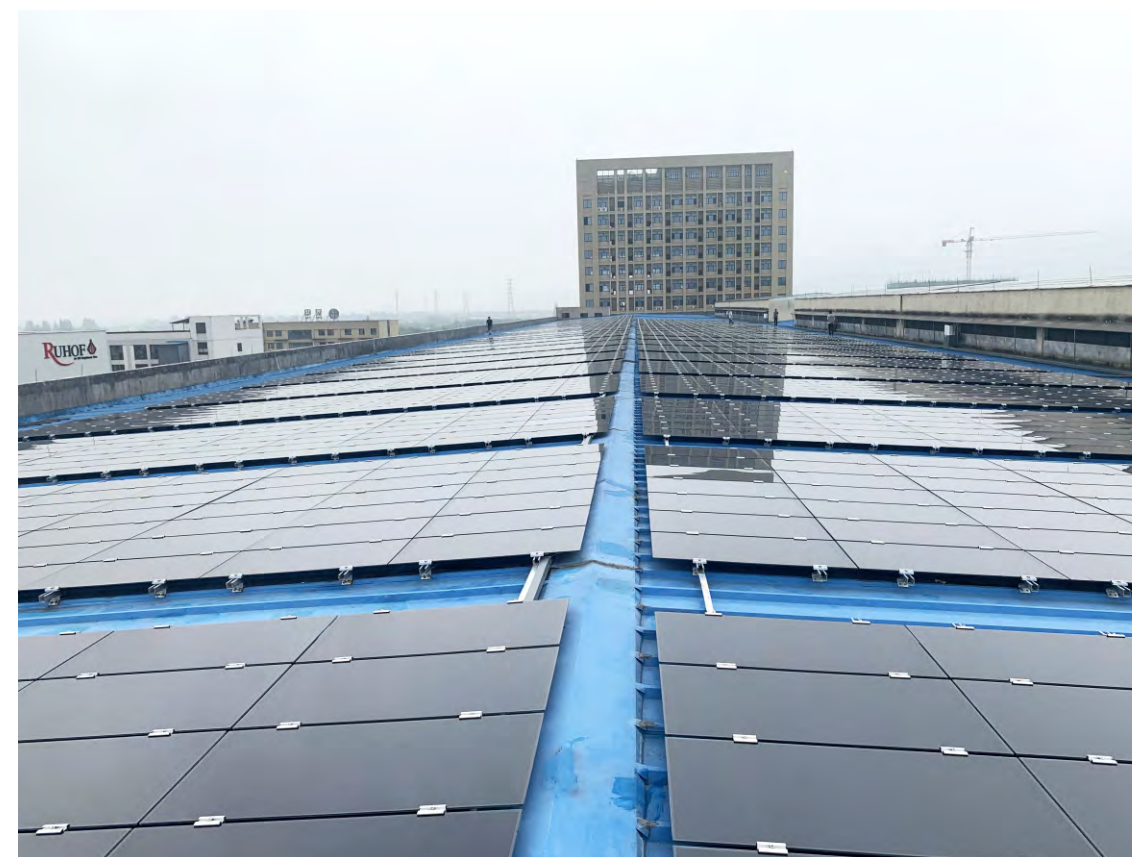
■ 以勒屋顶光伏电站
