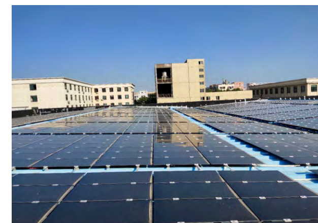
中益屋顶光伏电站
