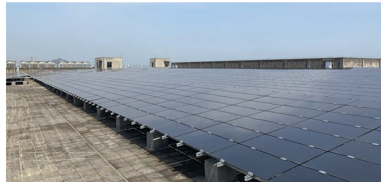
恒安屋顶光伏电站
