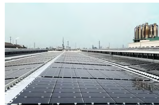
金昊屋顶光伏电站
