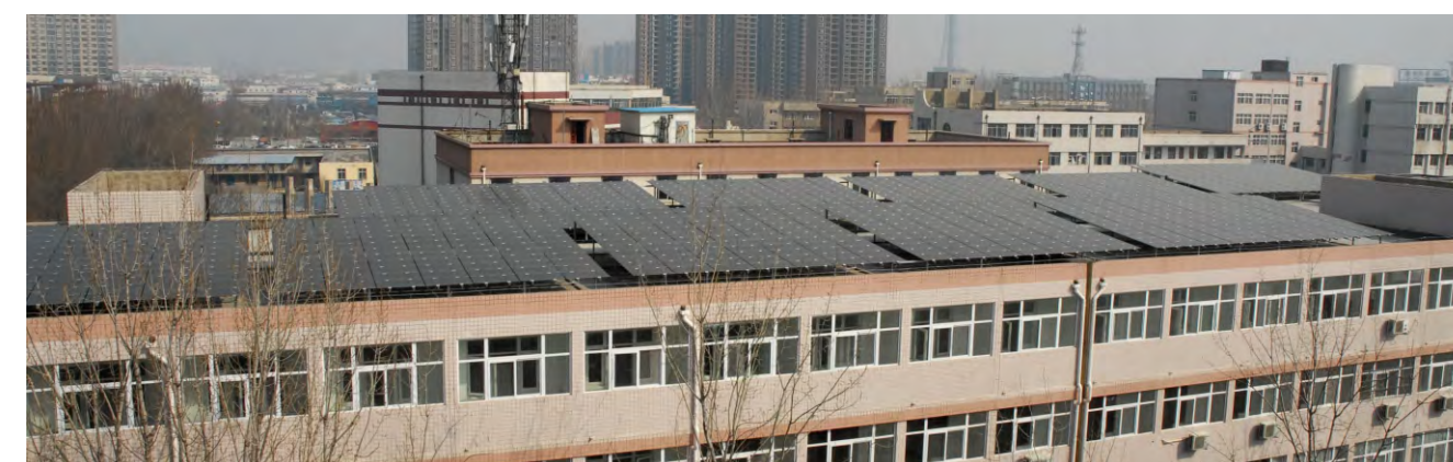
开封市政府屋顶光伏电站
