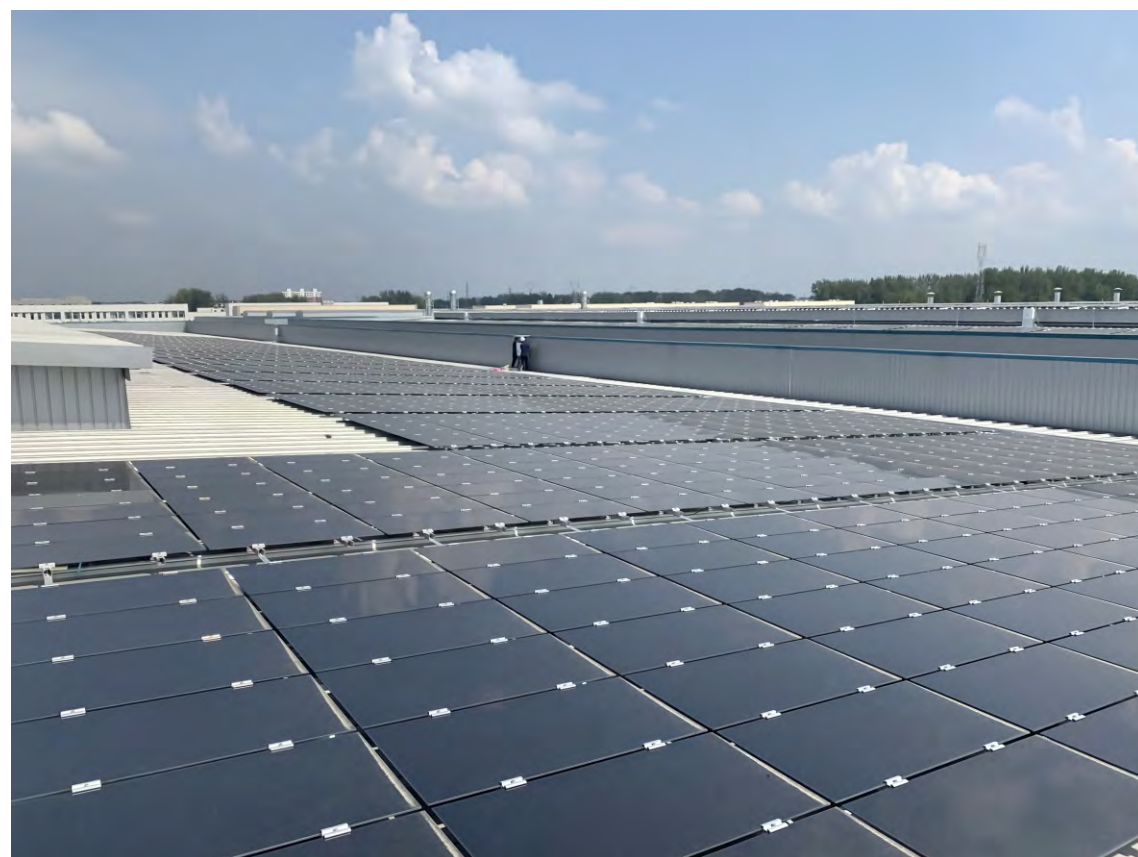
■ 金迪屋顶光伏电站
