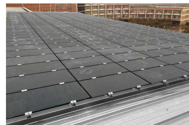
中国计量大学屋顶光伏电站
