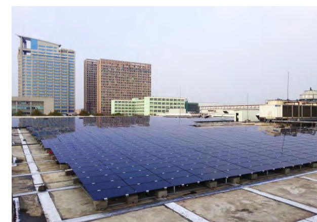
泰尔茂屋顶光伏电站
