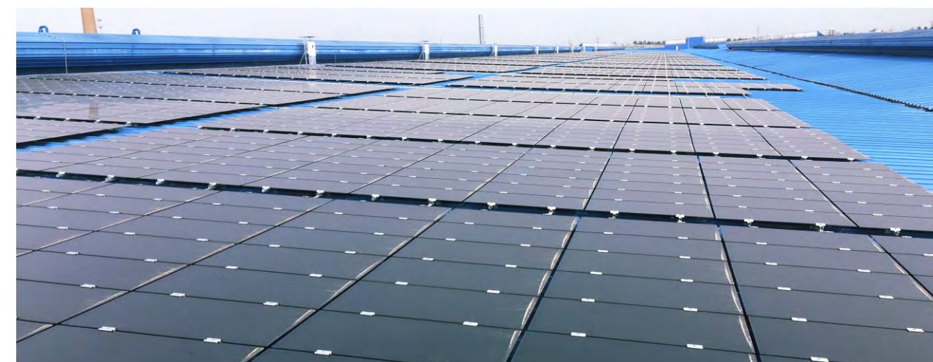
■ 聚润2.4MW屋顶光伏电站
