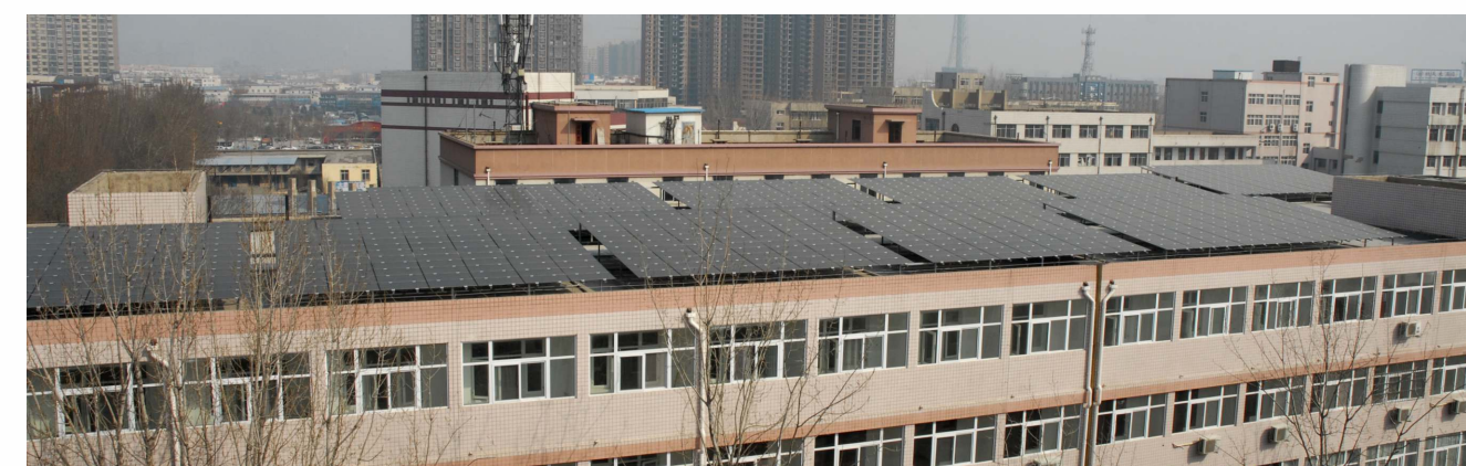
开封市政府屋顶光伏电站
