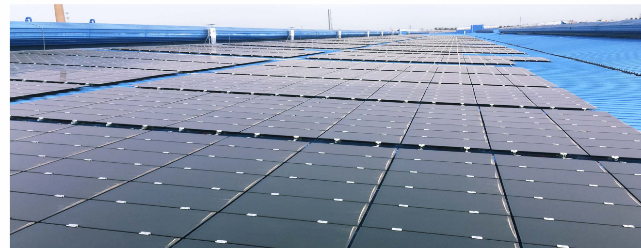
■ 聚润2.4MW屋顶光伏电站
