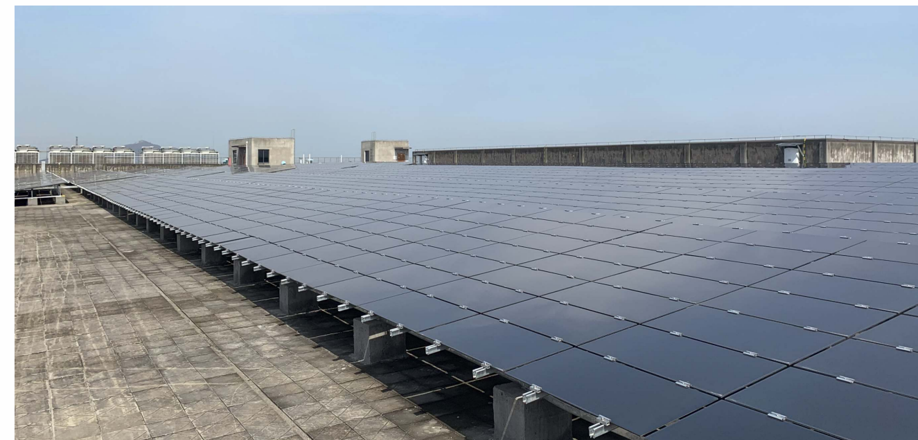
恒安屋顶光伏电站
