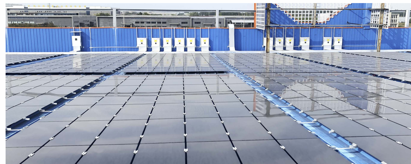
■ 润昌2.3MW屋顶光伏电站
