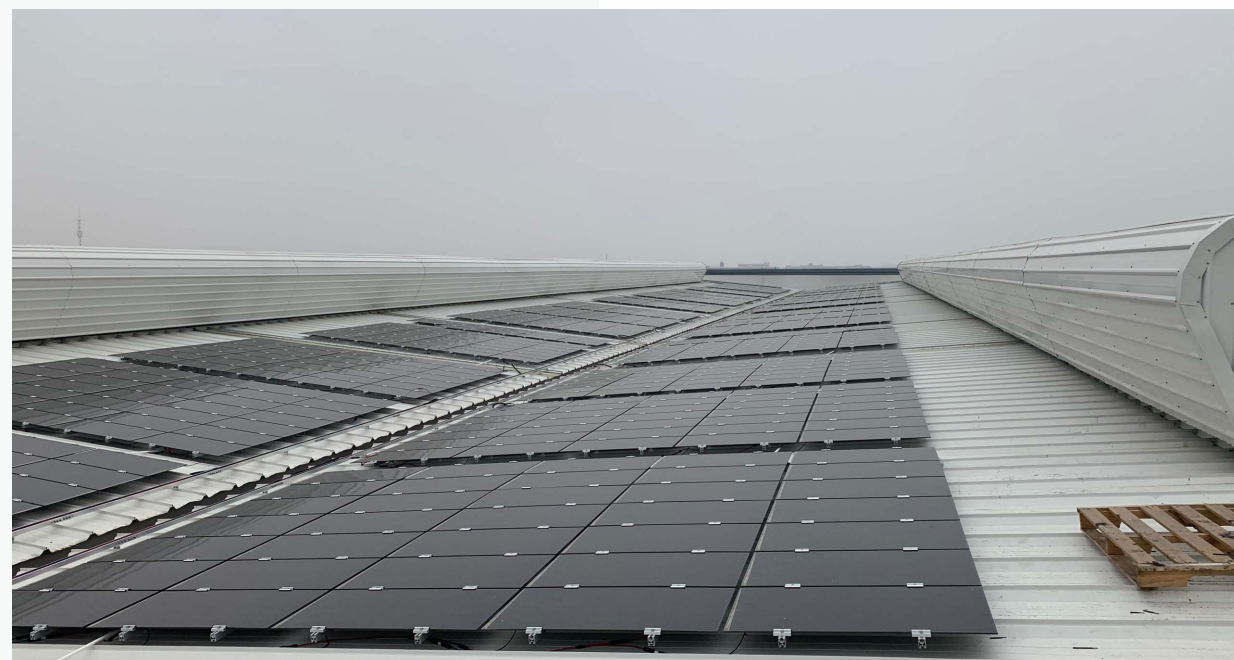
■ 新吉奥 5.4MW屋顶光伏电站
