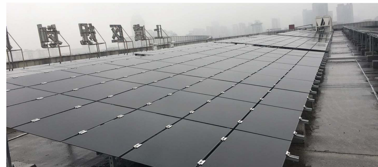
上虞规划局屋顶光伏电站
